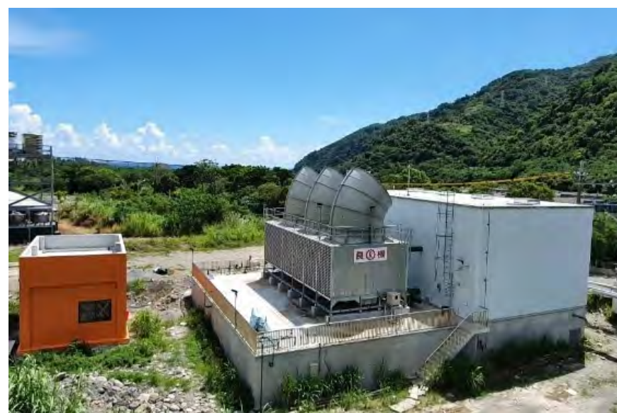
全陽公司-台東金崙地熱發電廠
